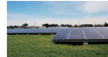
鶴ヶ島太陽光発電所
