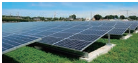
鶴ヶ島太陽光発電所
