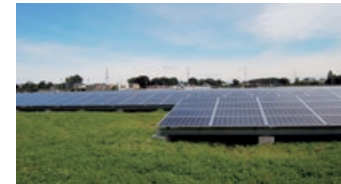
鶴ヶ島太陽光発電所
