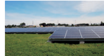
鶴ヶ島太陽光発電所
