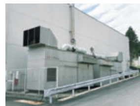
コージェネレーションシステムの外観
