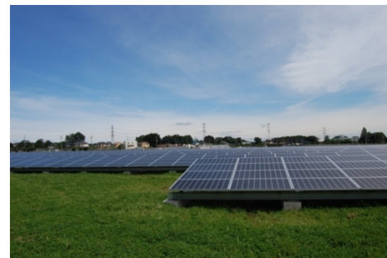
鶴ヶ島太陽光発電所
