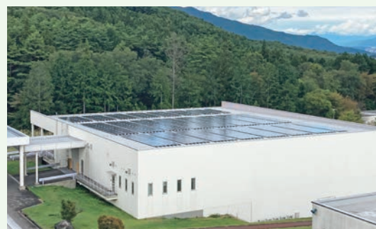
工場に設置した太陽光パネル
