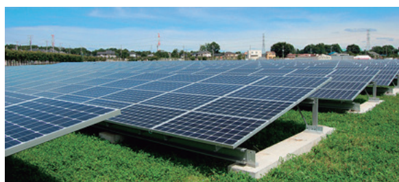
鶴ヶ島太陽光発電所
