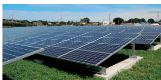
鹤岛太阳能发电厂（埼玉县鹤岛市）
